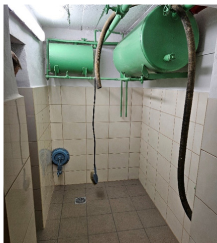
⑦ Komora dekontaminacyjna przeznaczona do wstępnego oczyszczania osób i sprzętu przed wejściem do czystej strefy budowli ochronnej, zintegrowana z instalacją wodno-kanalizacyjną obiektu
