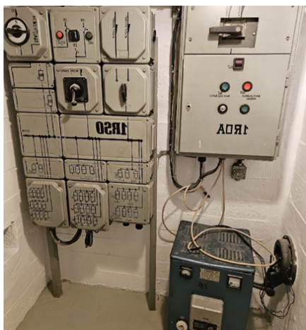
⑤ Rezerwowe zasilanie w postaci baterii akumulatorowych, stosowane przede wszystkim w schronach zakładów leczniczych oraz w stanowiskach kierowania obrony cywilnej
