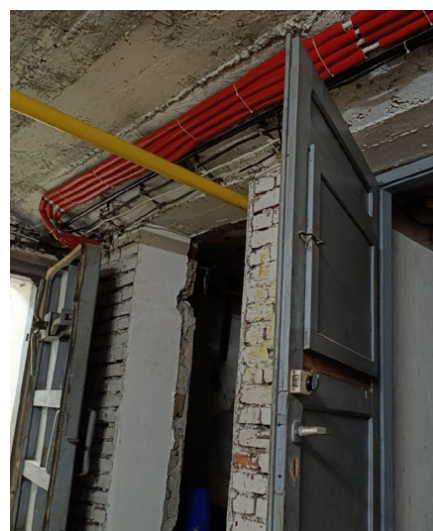
14 Instalacja gazowa przebiegająca wewnątrz budowli ochronnej
