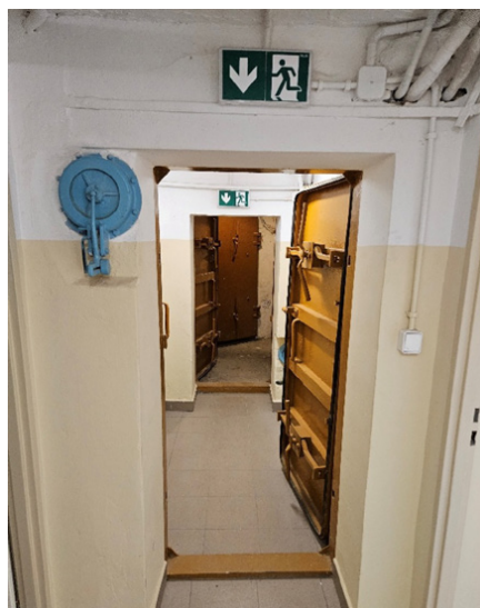
④ Instalacja awaryjnego oświetlenia ewakuacyjnego i oświetlenia zapasowego
