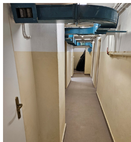
7 Widok przewodów wentylacyjnych rozproszonych po budowli ochronnej
