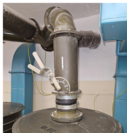
10 Zawór gazoszczelny na instalacji w pozycji otwartej
