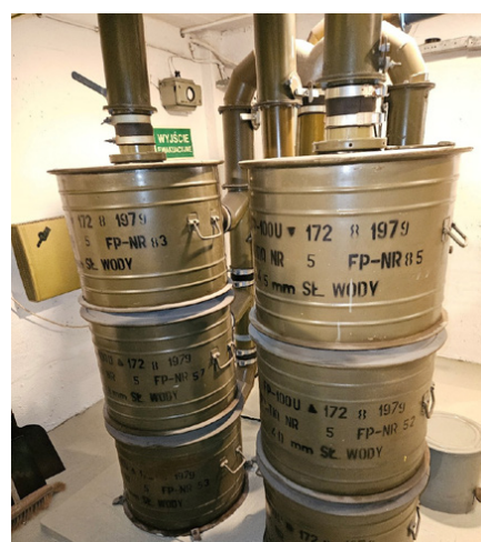
8 Sześć filtropochłaniaczy FP-100u zamontowanych w dwóch pionowych kolumnach na wspólnej ramie przytwierdzonych do płyty fundamentowej
