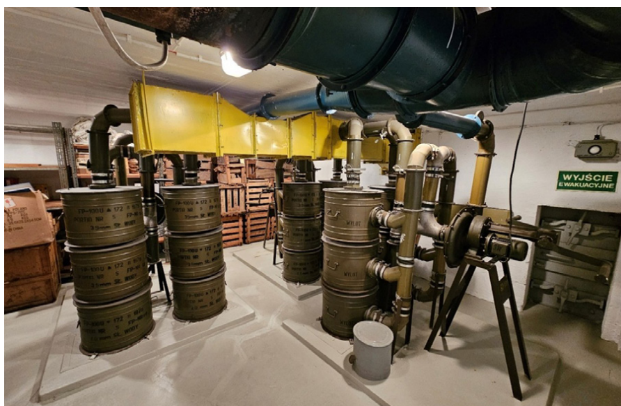
9 Rozbudowany układ urządzeń filtrowentylacyjnych w budowli ochronnej
