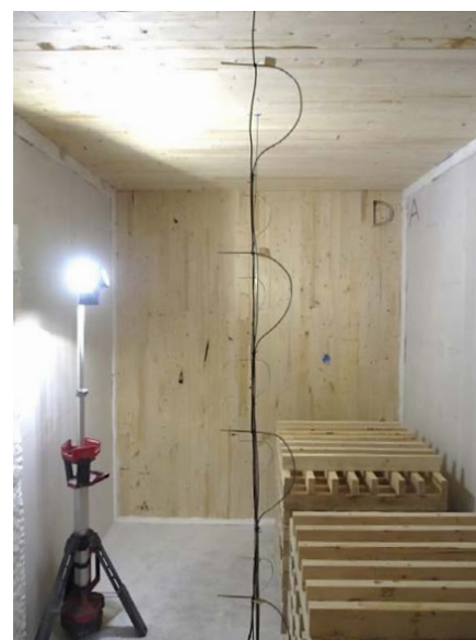
❷ Ściany A i C pokryte płytą GK (lewa i prawa strona), sufit i ściana frontowa wykonana z CLT
