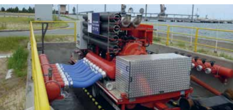
6 Agregat pompowy o wydajności 25 000 l/min
