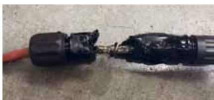
Rys. 3. Spalona niezgodna para złączy
