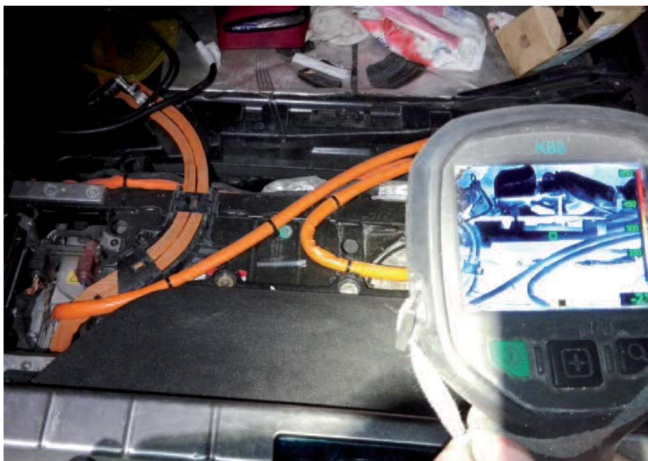
Fot. 4. Kontrola temperatury baterii wysokonapięciowej
