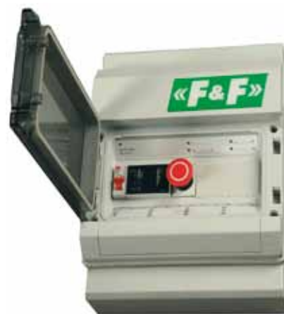
↑ Rozdzielnia i sterownik SAM 01
