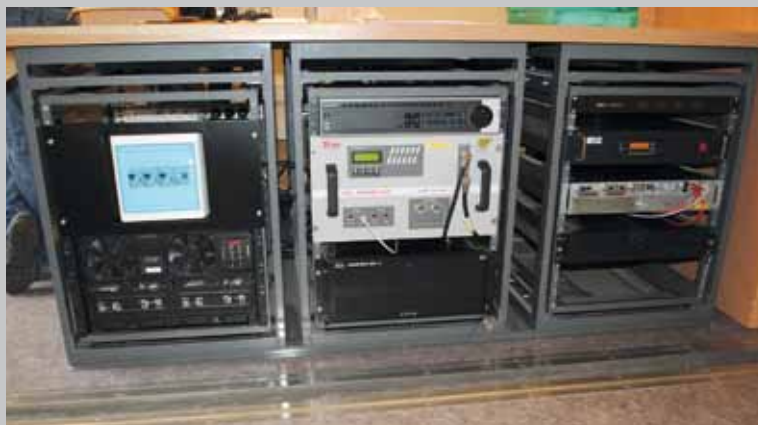
↑ Sprzęt teleinformatyczny stanowiący wyposażenie samochodu, zabudowany pod stołem w szafach rack 19"
